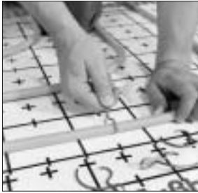
12. Einsinken der Handanker auf geraden Stücken im Abstand von etwa 0,5 m sowie vor und nach jedem Bogen. Als Alternative steht das Setzgerät mit den Doppelankern zur Verfügung. Bei Gussasphalt kommt nur der Doppelanker zum Einsatz.
