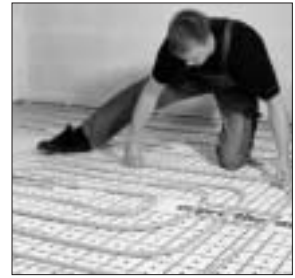
11. Nach Ausrollen eines Ringes ausrichten der Rohre in vertikaler und horizontaler Richtung. Rohre so ausrichten, daß sie flach auf dem Boden aufliegen und keine Rollkrümmung mehr aufweisen.
