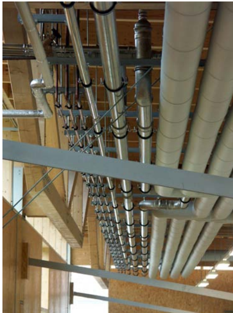
Abb. 4: Verrohrung der Maschinenkühlung im SANHA®-NiroSan® -Presssystem (Werkbild: SANHA Kaimer GmbH & Co. KG)
